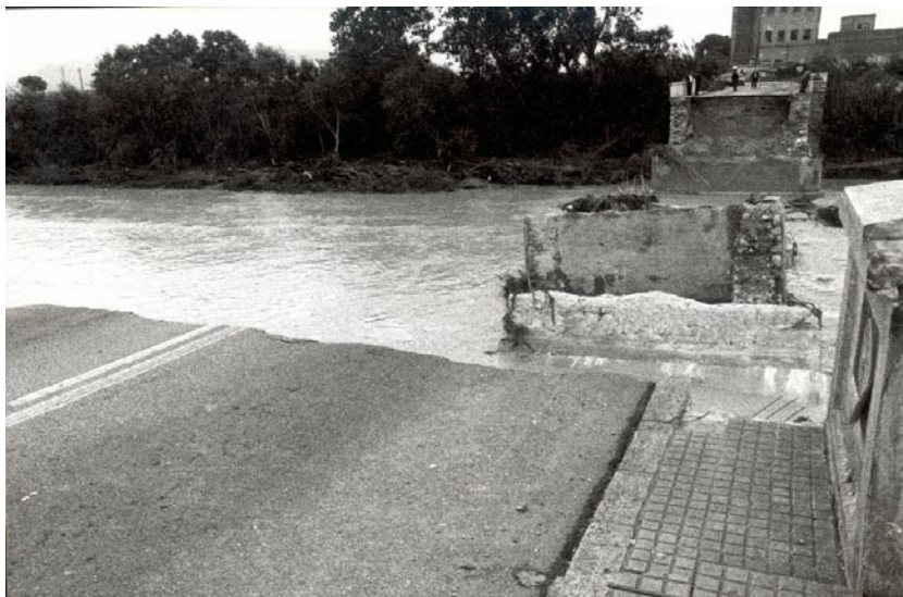
El puente de Daimús no resistió la fuerza de la lluvia y acabó derruyéndose. Miles de curiosos se acercaron esos días para contemplar la grotesca imagen. / Arxiu Històric de Gandia / Ximo Ferrí
